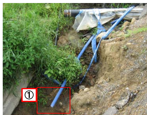
写真2. 端部破損箇所詳細(谷側から撮影)
