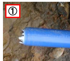
写真3. 端部破損状況詳細(拡大) 残った地盤側から3m露出し、 継手近傍の管で破断している
