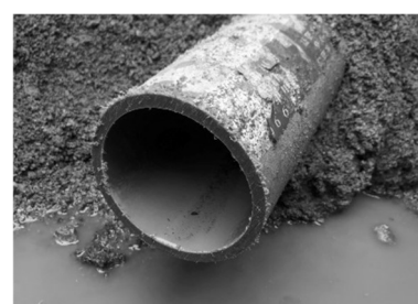
写真5 経年管の内外面
