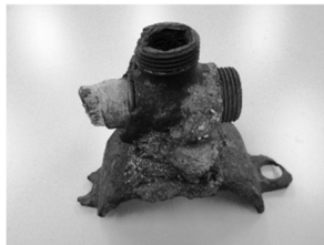
写真2 腐食したサドル
