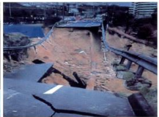
写真5：阪神・淡路大震災で宙ぶりになった都市ガス導管 (ガス地震対策検討会報告書(1996年1月)より)
