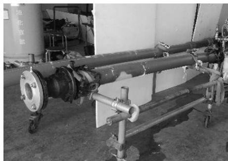
写真1 凍結対象配管 (全体)
