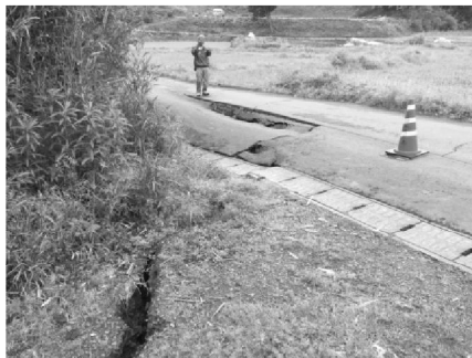
写真 1 舗装面の損傷状況（砥川地区）
