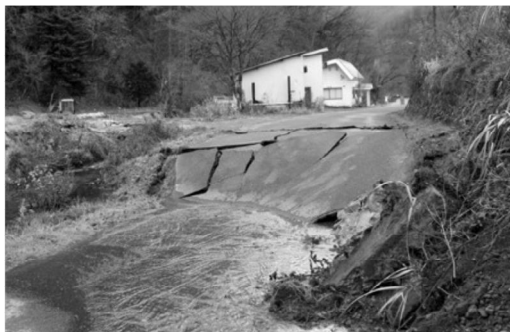
写真1 塩島地区地表変位(垂直変位約80cm)
