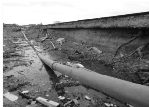
写真 1,2 津波で洗掘された青ポリ管と管に付いた傷
