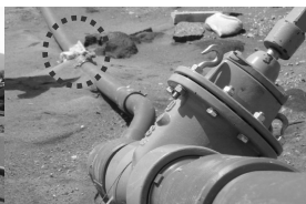
写真 7 残った継手類 手前は仕切弁 奥にはメカニカル継手(点線)
