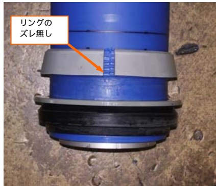
写真 2 抜け止めリングの状況
