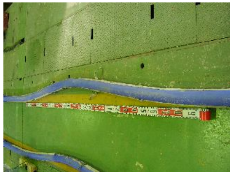
図4：掘り起こした管の変形状況
