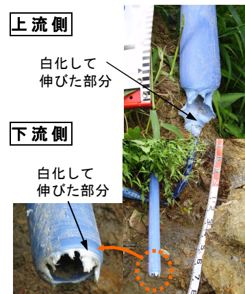
写真1 WPE 管破断部の状況
